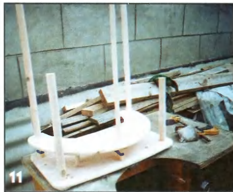
Креплю изолентой к стойкам ограничители высоты второй полки и приклеиваю на место вторую полку с ее опорными шайбами.
